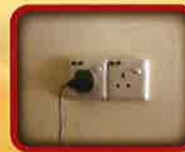
socket tidak berfungsi
