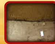
keretakan pada lantai
