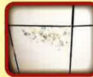
kesan bocor pada siling
