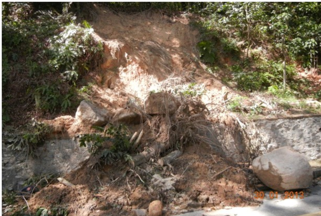
Terdapat bungkah batu yang besar ketika runtuh cerun belaku dan ini boleh mengancam keselamatan pengguna
