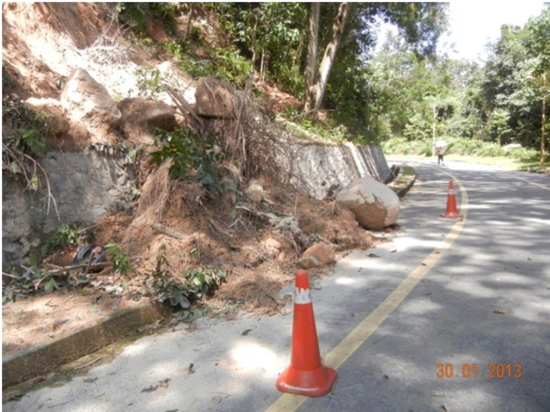
Keadaan cerun yang curam bderisiko tinggi kepada keruntuhan cerun akan berlaku
